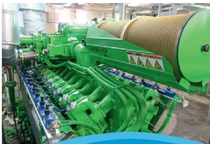
Bild: © Stadtwerke Fürstfeldbruck – das neue BHKW im Kraftwerk ‚Auf der Lände‘
